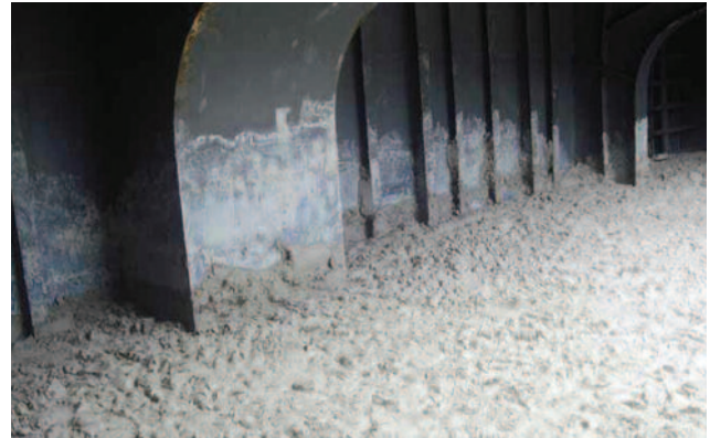
Cận hàng hóa trên khung thép bên trong khoang cho thấy mức độ dịch chuyển hàng hóa
